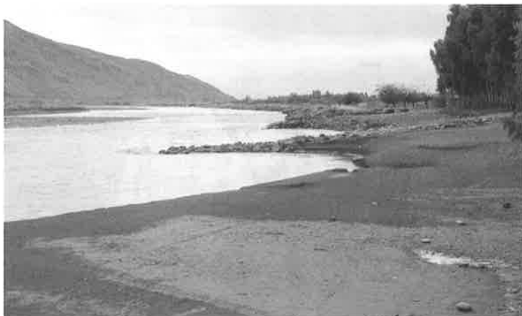
ミラン護岸始点から上流側に石出し水制を5基造成した。洪水後、水制間に膨大な砂が堆積し樹木の後ろを走る国道を保護している。
