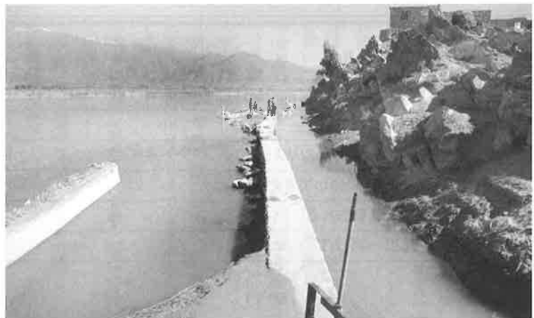
ここ数年の洪水で殆ど壊滅した既存の取水堰と取水口 ミラーン堰上流対岸 (2016年2月17日)
