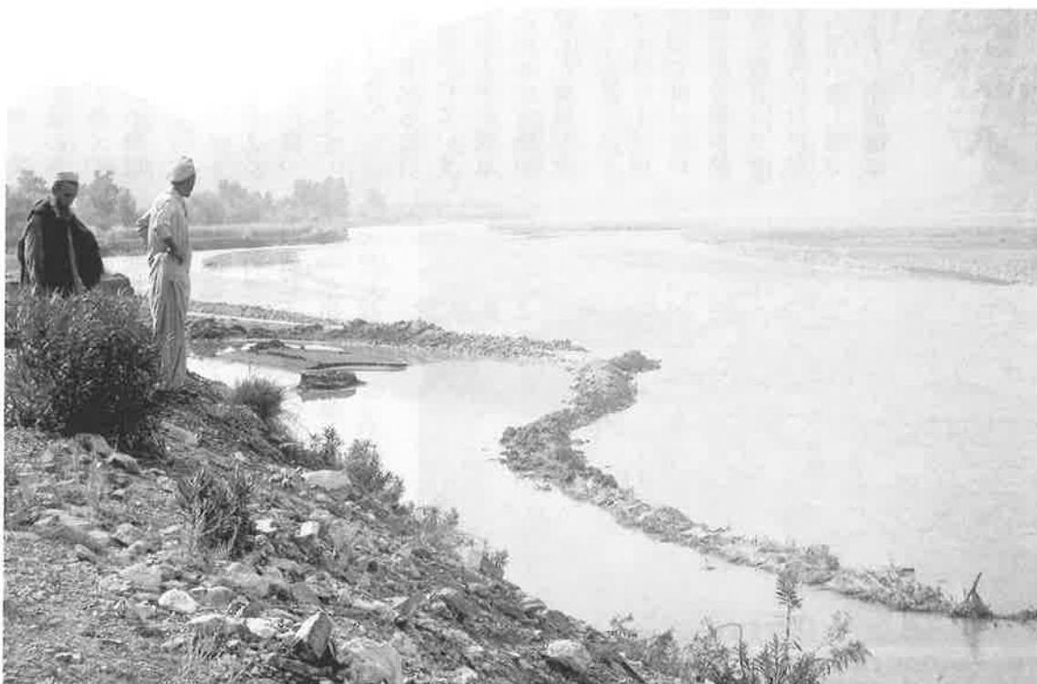
洪水で崩壊したコンクリート突堤のバルカシコート既存水路。突堤の先端が洗掘され水が取水口に流れなくなり、村民による堰上げの跡が見られる（2015年10月14日）
