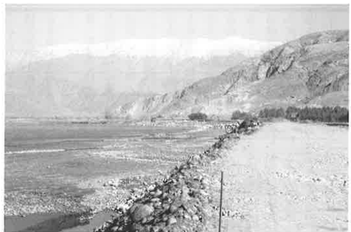
雪が薄く山肌が見える、積雪のケシュマンド山脈。しめきり堤工事現場から撮影 (2016年2月16日)
