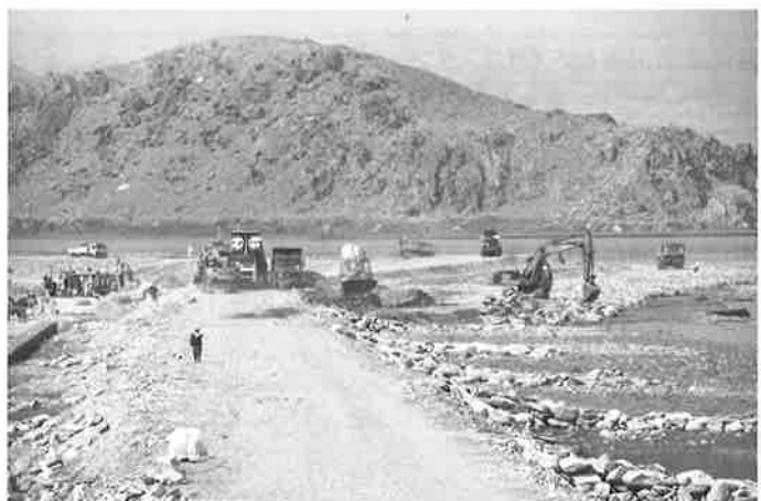
今夏は2010年規模の大洪水が予想され、村や田畑を守るため必死で護岸工事が進められた。マルワリードII用水路周辺クナル河(2017年7月25日)
